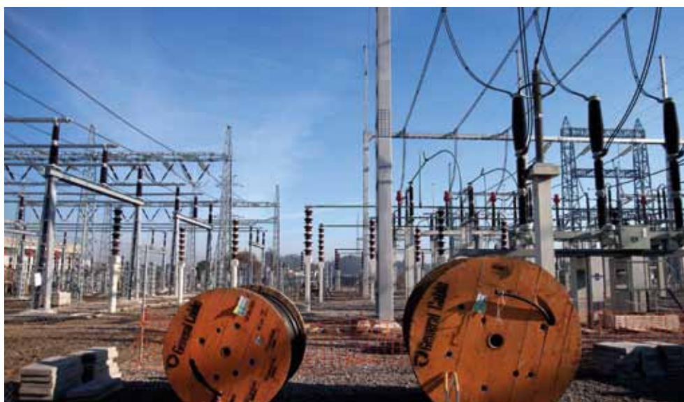
SUBESTAÇÃO de Vermoim
