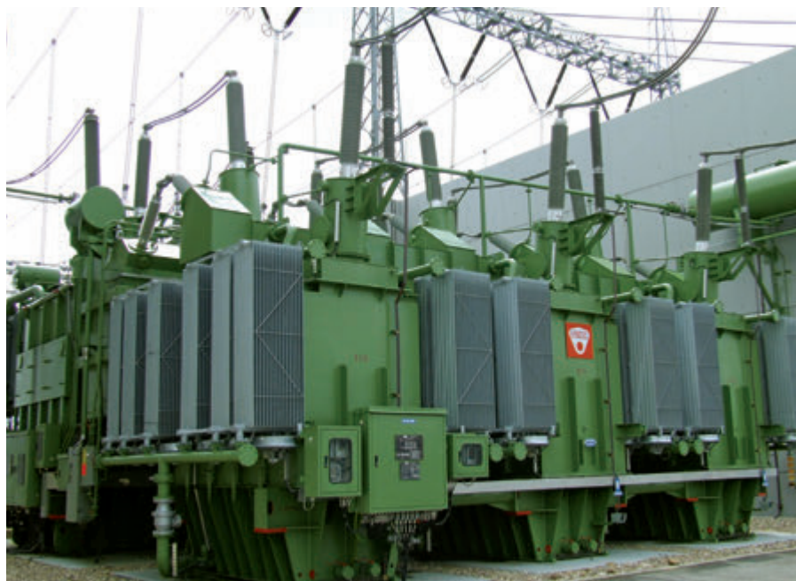
Autotransformador na subestação de Pedralva
