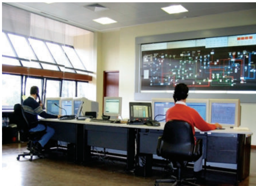
Centro de Operação da Rede
