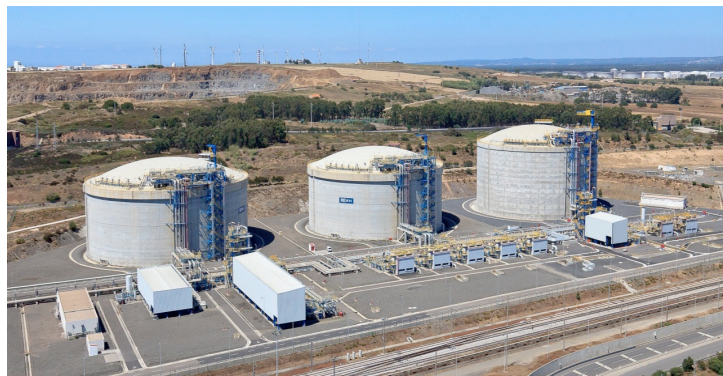
LNG Terminal - Storage
